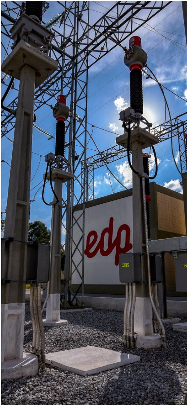
Subestação Vila Paiva – EDP São Paulo.
