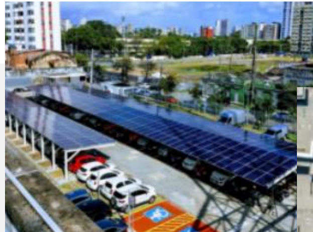
Usina solar Globo - Recife
